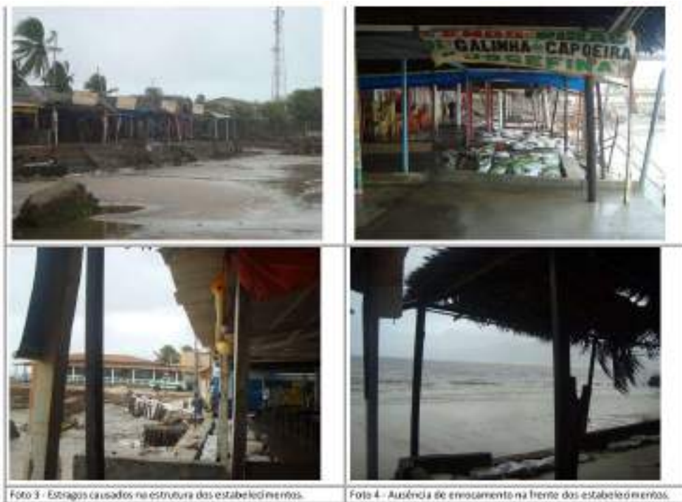
Foto 3 - Estragos causados na estrutura dos estabelecimentos.
